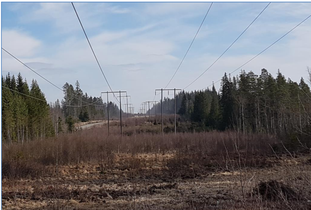
Bild 1. Foto över befintliga luftledningar LL1 och LL3 strax öster om Sökandens befintliga station Hällsjön. Ny 132 kV ledning kommer att anslutas till befintligt elnät vid denna plats.
