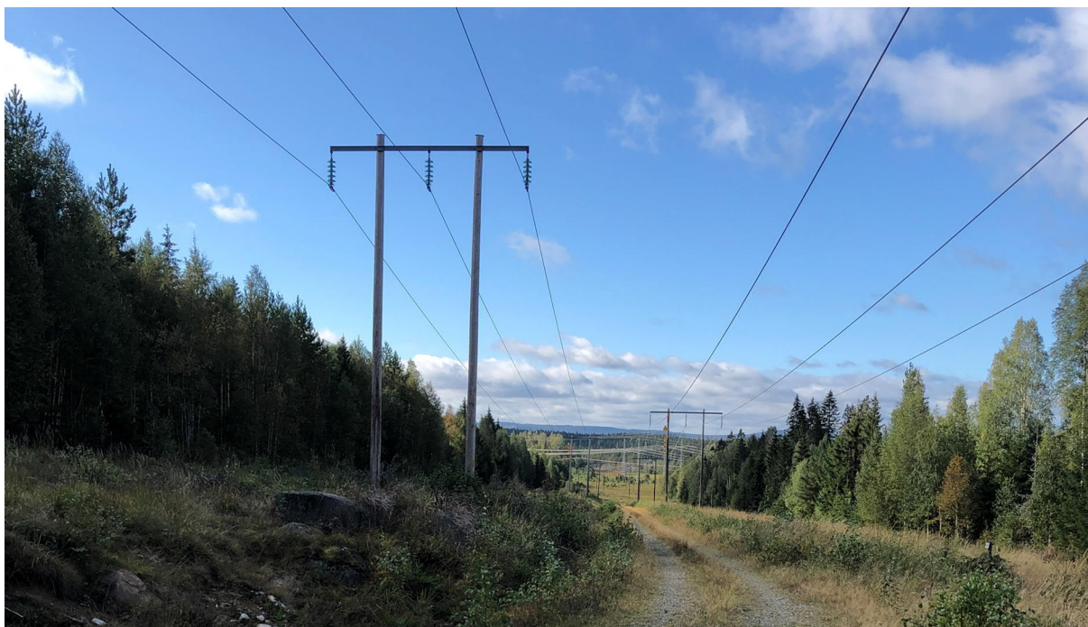
Figur 1. Foto över befintliga luftledningar LL1, till vänster i bilden, och LL3. Aktuell ledning kommer att gå i oförändrad sträckning mellan Lernbo och Grängesberg
