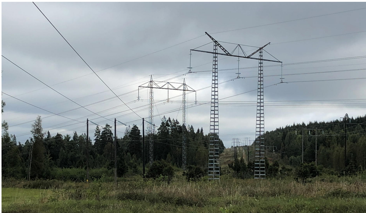
Figur 13. Korsande 400 kV ledning vid Torptjärn
