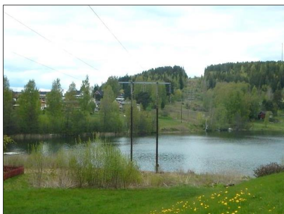
Figur 2. Befintlig luftledning i träportalstolpar vid Knutsbotjärn.
