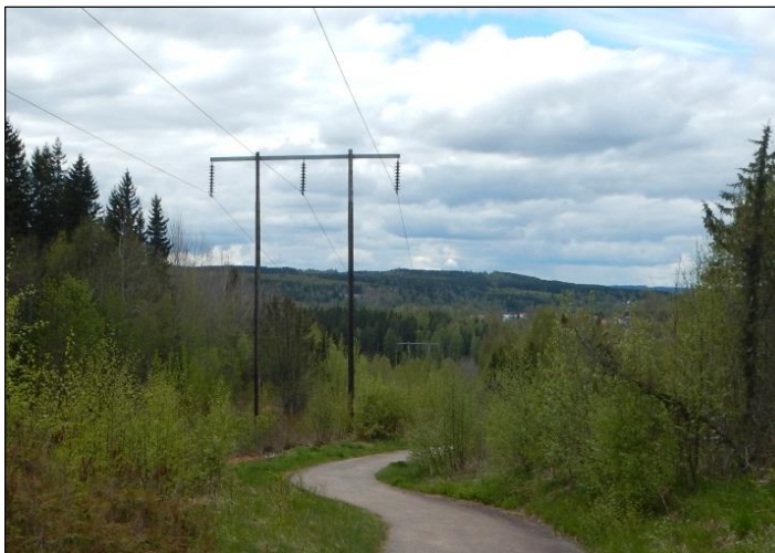
Figur 1. Foto på befintlig luftledning längs gångvägen i södra utkanten av Knutsbo.
