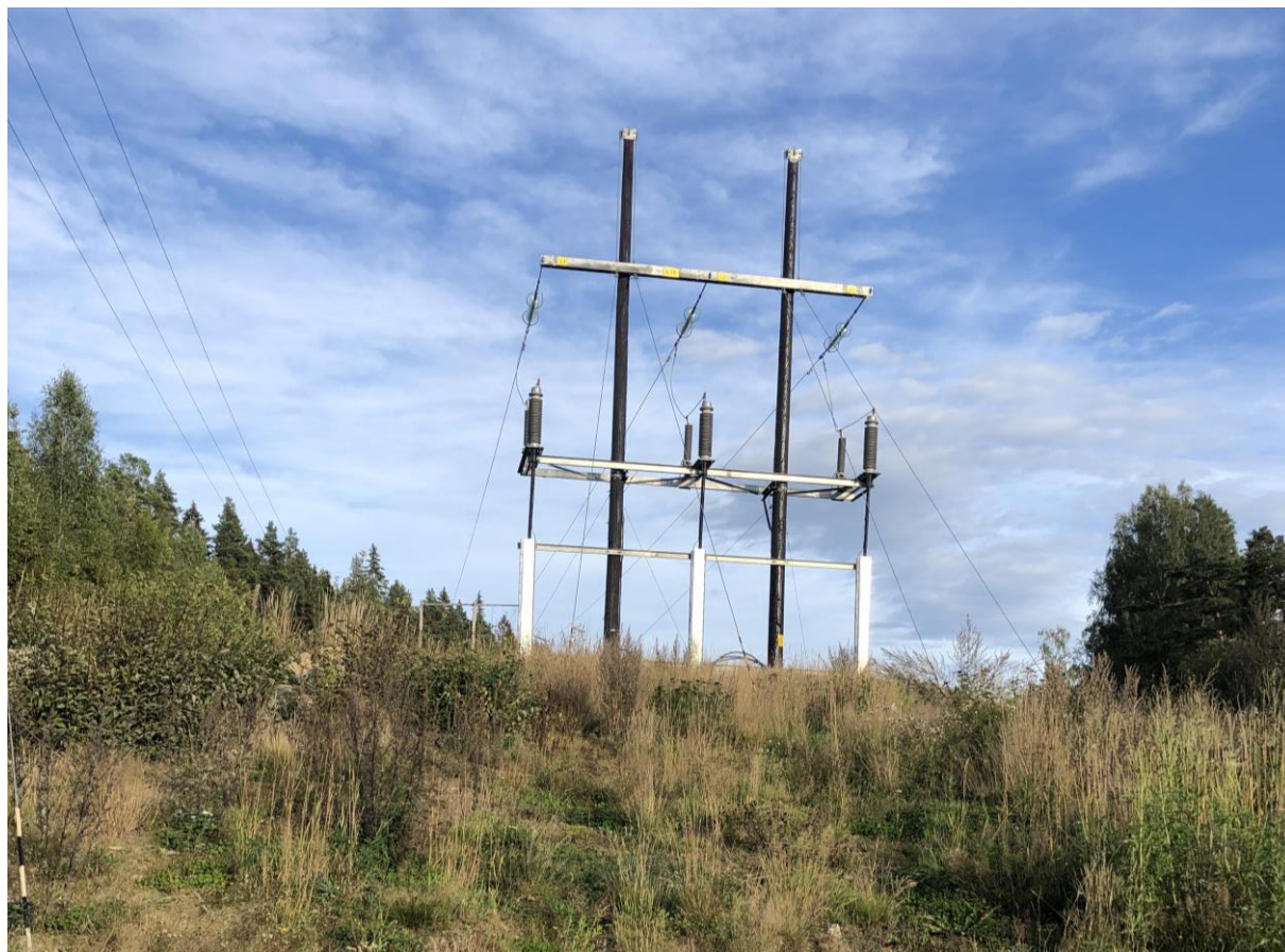
Figur 7. Kabelstolpen vid Bårudden varifrån befintlig 130 kV kraftledning förändras. Ny anslutningspunkt blir ca 100 innan denna punkt vilket innebär att stolpen försvinner.
